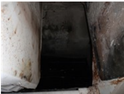
Abb. 1: Mögliche Absturzstelle, ca. 4 m Tiefe
