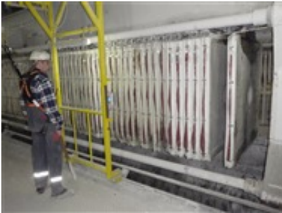
Abb. 4: Der Mitarbeiter positioniert sich hinter dem Schutzgestell
