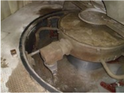
Geöffneter Mischer mit sichtbaren Mischarmern
